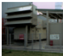
コ・ジェネレーションシステム
