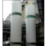
CO 2 貯槽タンク
