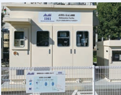
CO 2 の有効利用を志向したメタネーション装置
