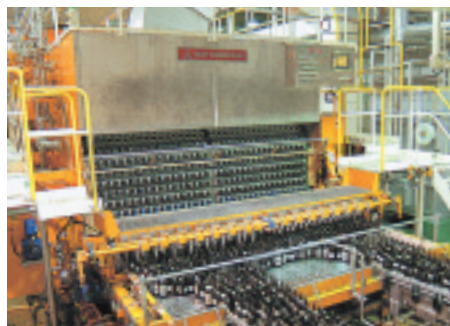
水の循環利用を実施している洗びん機
