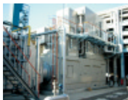
コ・ジェネレーションシステム
