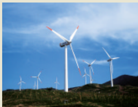
風力発電設備
